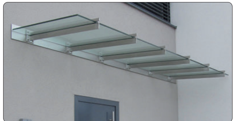
Verbaut an einem Privathaus
